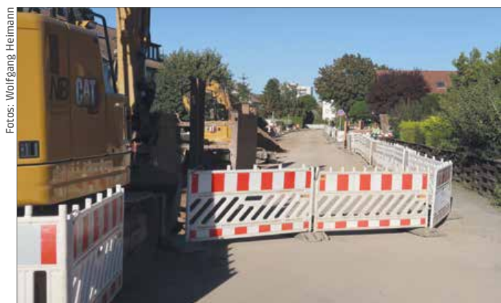
Kein neuer Sachstand zu den Fortschritten bei der Kanalsanierung in der Salzwiese.
